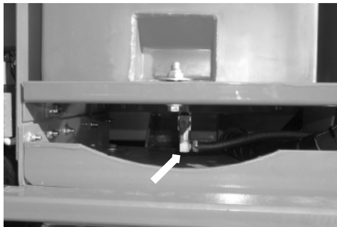
Fig. 7.4 - Bränsleläckage vid tanken
